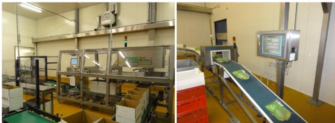
Vue de l'automatisation en fin de ligne
